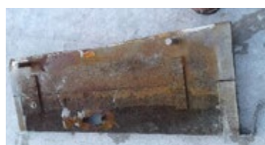
Dégradations et démontages sauvages réguliers du batardeau
