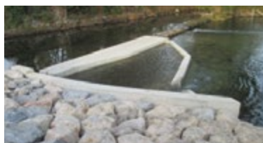
Passé à poissons des Gaffins - Monteux
